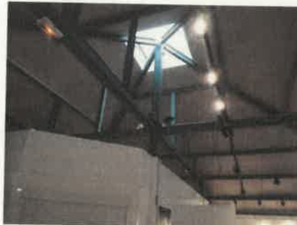
Vue intérieure de l'ouvrant de désenfumage au faitage
